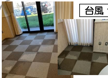
↑乳幼児室と図書室が 浸水してしまいました
